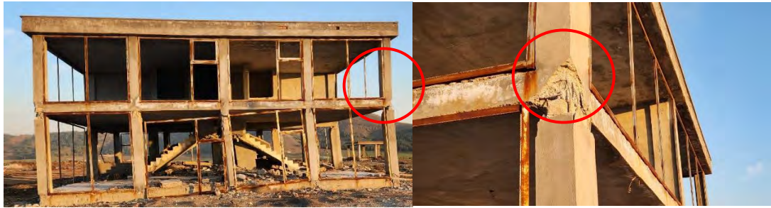
Şekil 107. Betonarme sanayi yapısı hasarları (Gaziantep Nurdağı)
