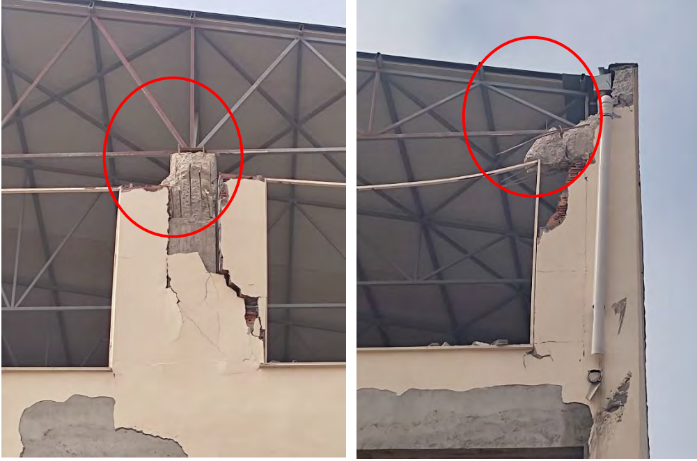
Şekil 105. Yetersiz birleşim sonucu ayrılan kiriş hasarı (Kahramanmaraş)
