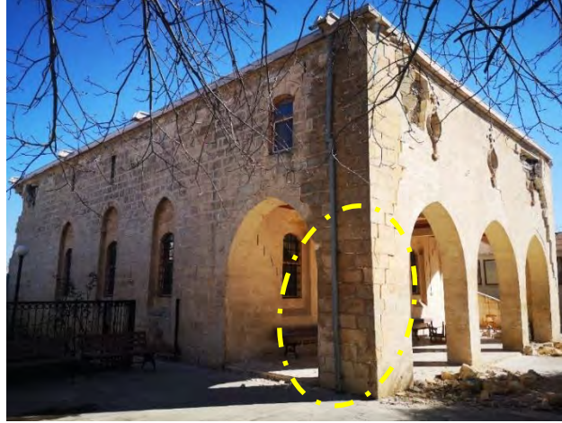
Şekil 135. Ayakta meydana gelen çatlaklar
