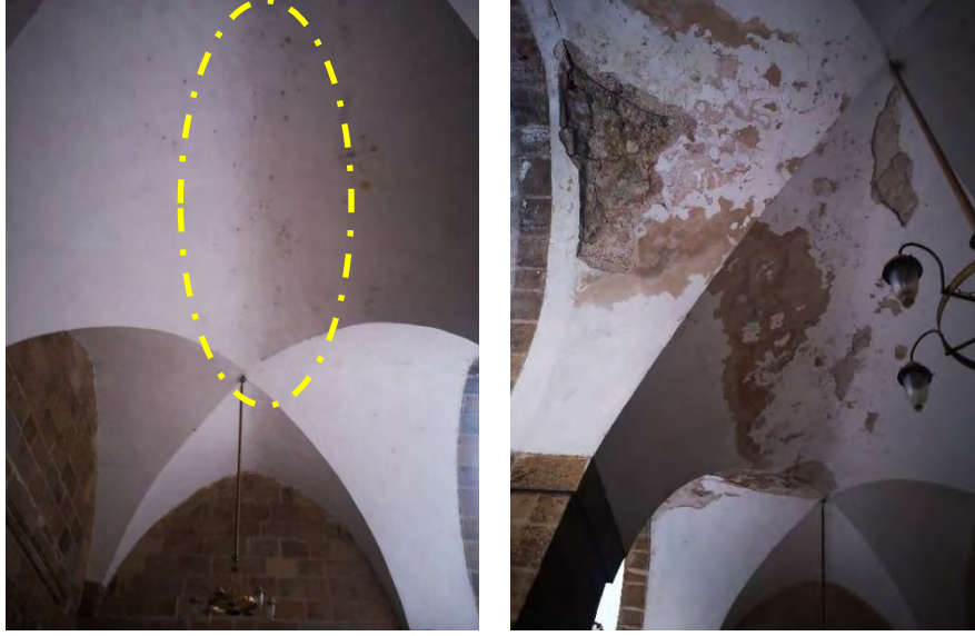
Şekil 145. Tonozlarda oluşan çatlak ve hasarlar
