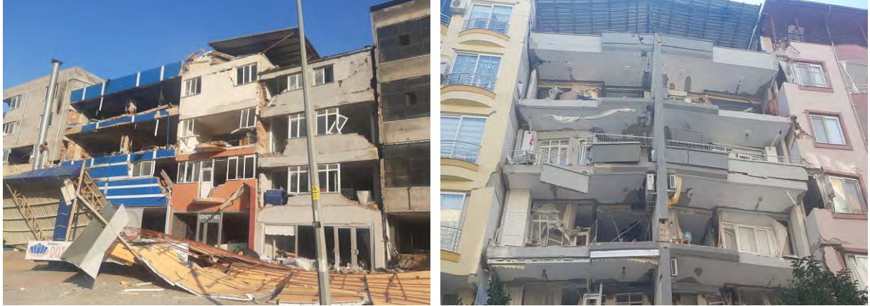
Şekil 71. Bitişik nizam yapılarda meydana gelen hasarlar
