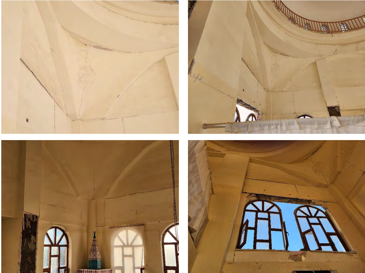
Şekil 170. Betonarme camilerde gözlemlenen pandantif hasarları
