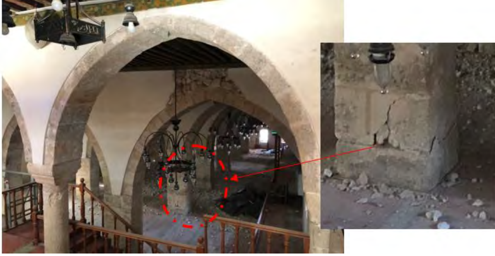
Şekil 154. Cami ayaklarında oluşan hasarlar
