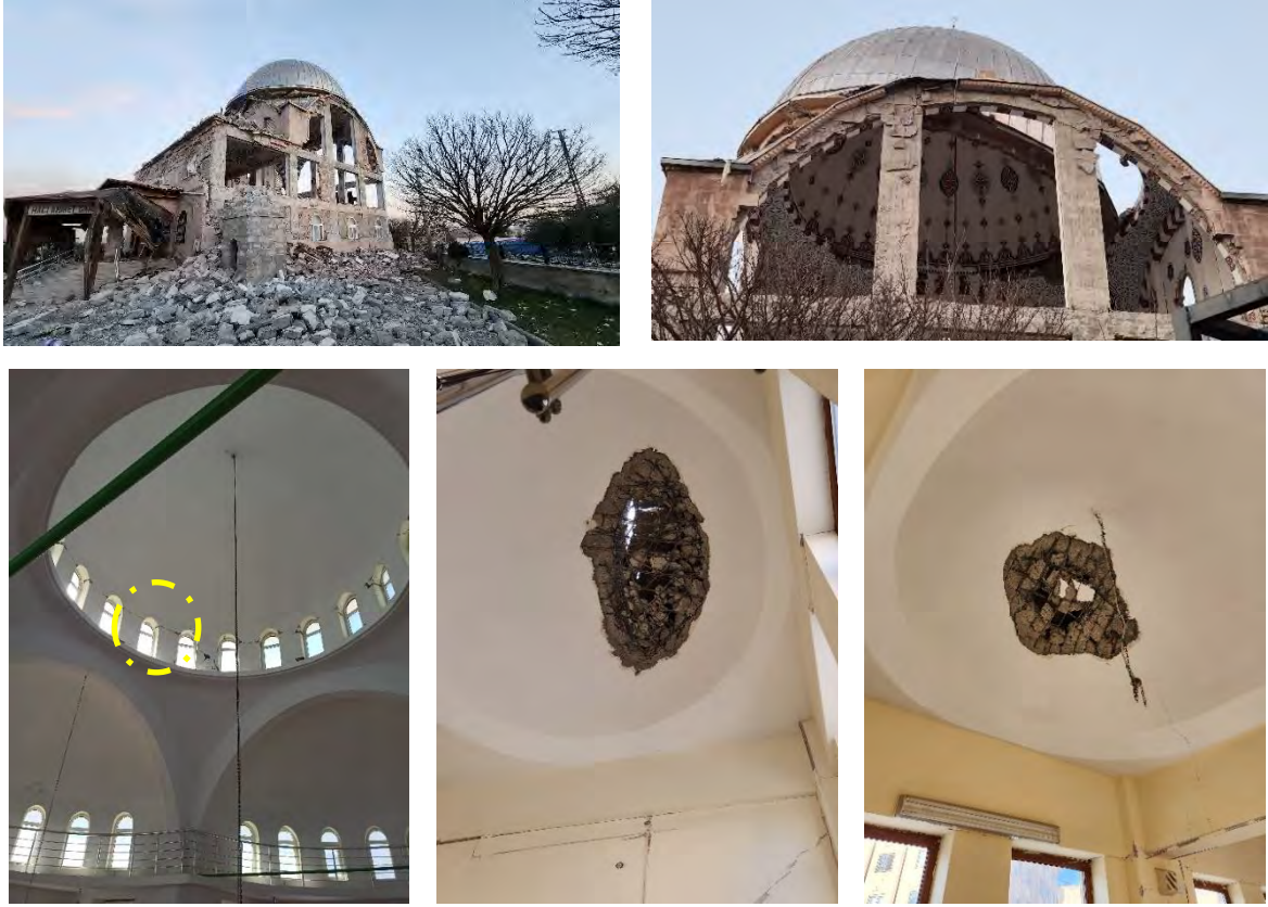
Şekil 169. Betonarme camilerde gözlemlenen kubbe hasarları
