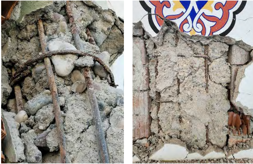
Şekil 176. Betonarme camilerde gözlemlenen yetersiz beton kalitesi
