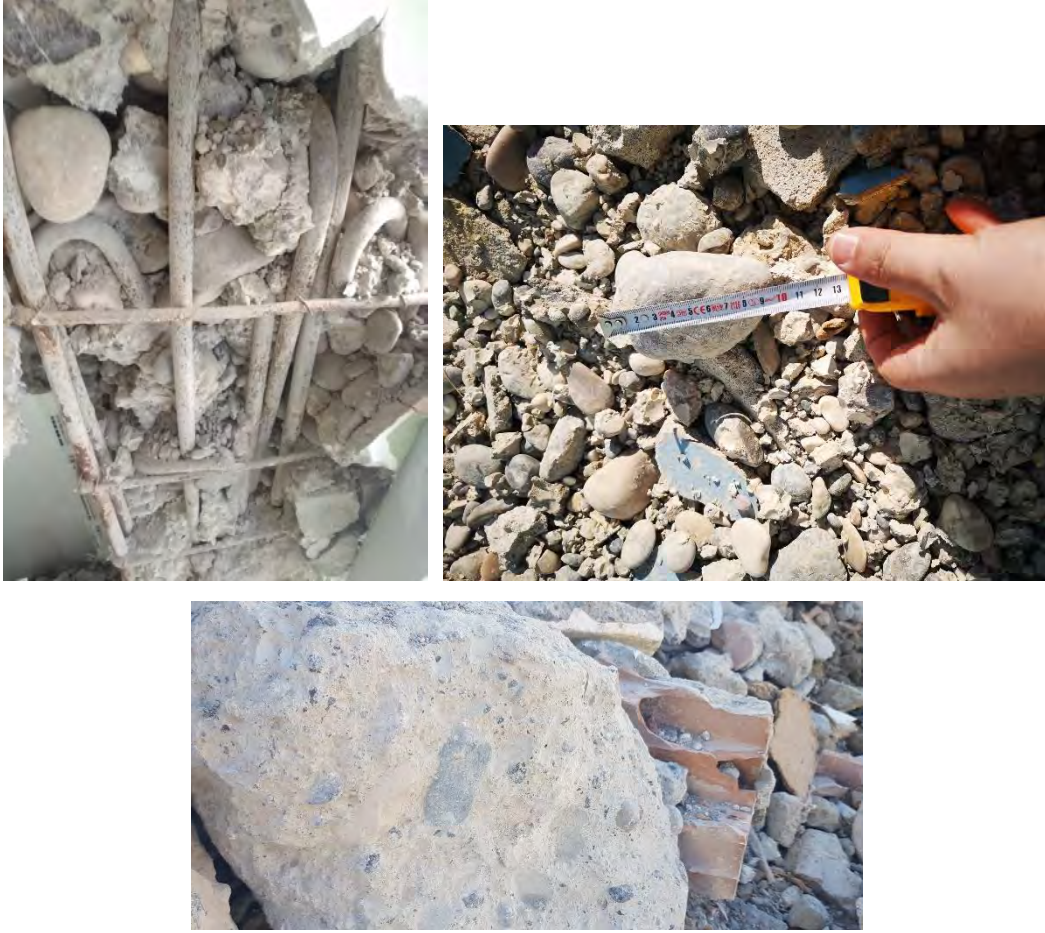
Şekil 78. Düşük beton kalitesine ait görseller
