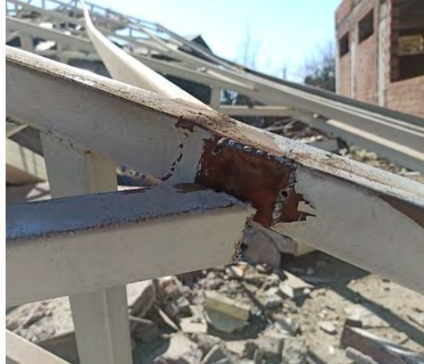
(c) Hatalı kaynak uygulaması ve korozyon
