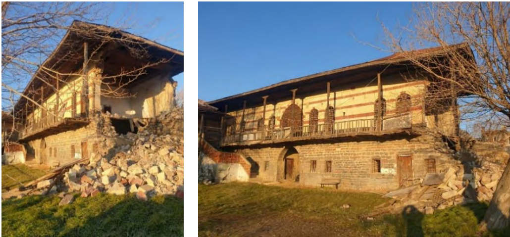
Şekil 155. Düzlem dışı etkilerden kaynaklı göçme
