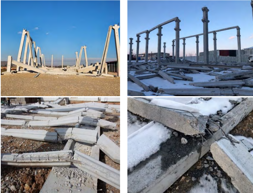
Şekil 109. Yapıdan ayrılan aşık kiriş hasarları
