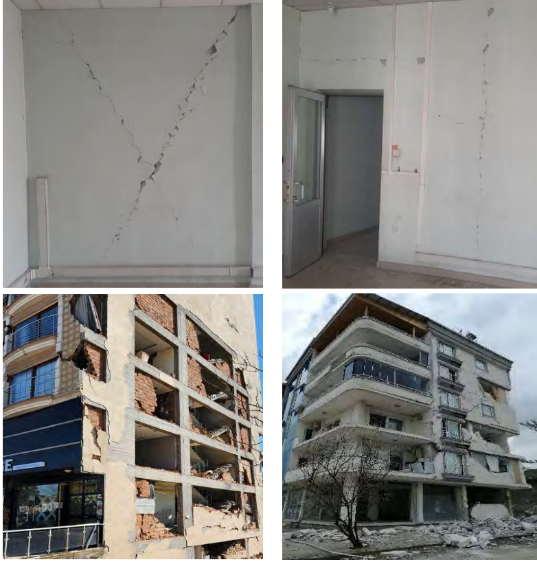
Şekil 69. Zayıf dolgu duvar hasarları
