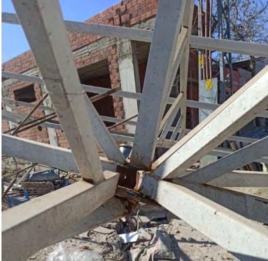
(b) Hatalı detaylandırma ve korozyon
