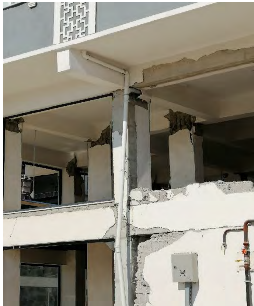
Şekil 75. Asmolen döşeme uygulamasının neden olduğu hasarlar
