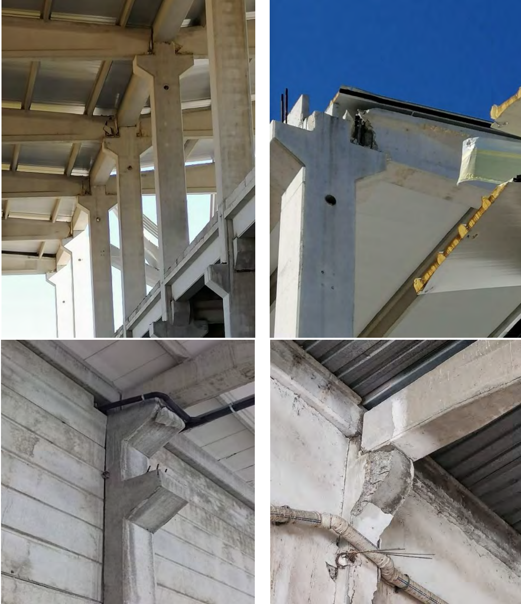
Şekil 111. Çatı kiriş ve konsol uç bölgesi hasarları
