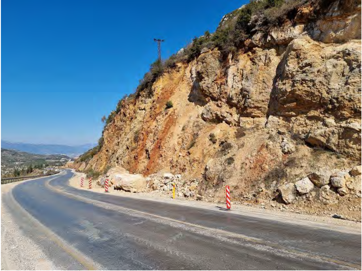
Şekil 62. Hatay Altınözü yolu üzerindeki kaya düşmesi
