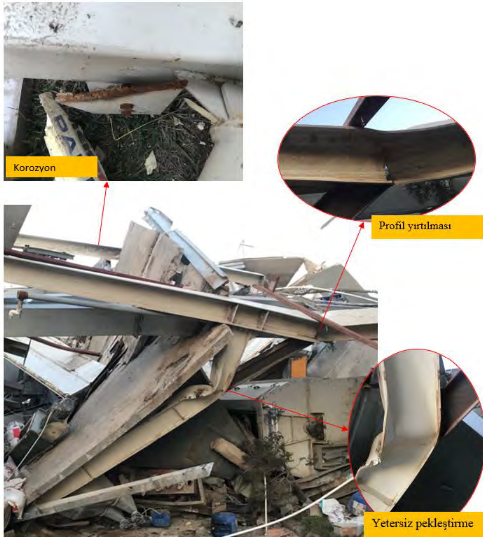
Şekil 102. Yıkılan bir çelik fabrikanın hasar incelemesi (Kahramanmaraş)
