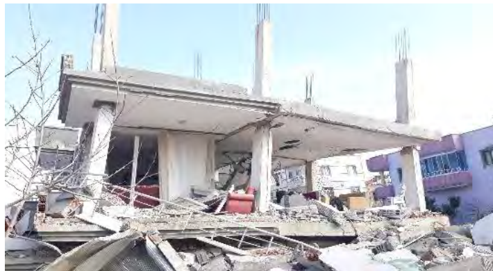
Şekil 73. Asmolen döşeme uygulamasının neden olduğu hasarlar
