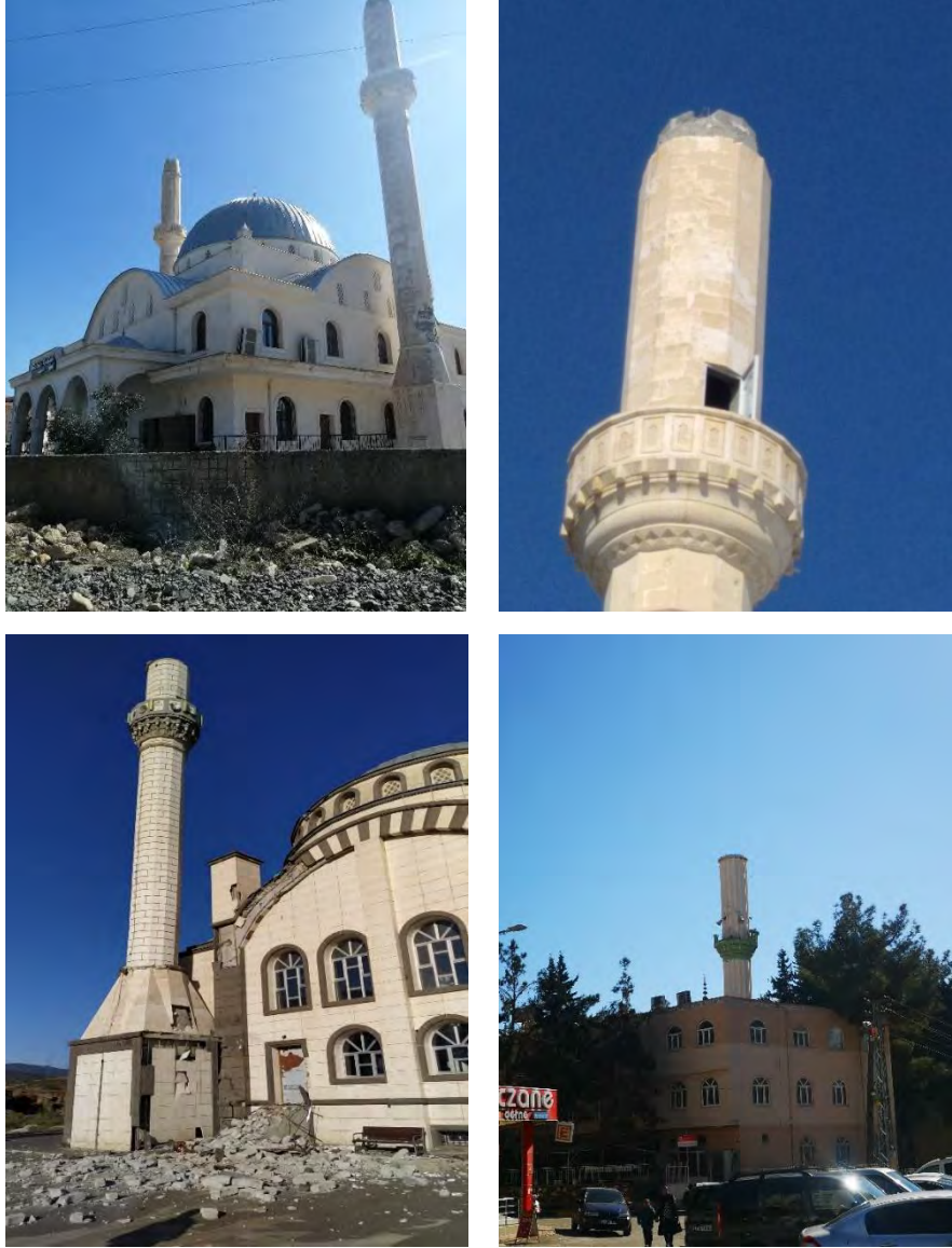
Şekil 183. Betonarme minarenin petek ile külâh arasındaki hasarlar
