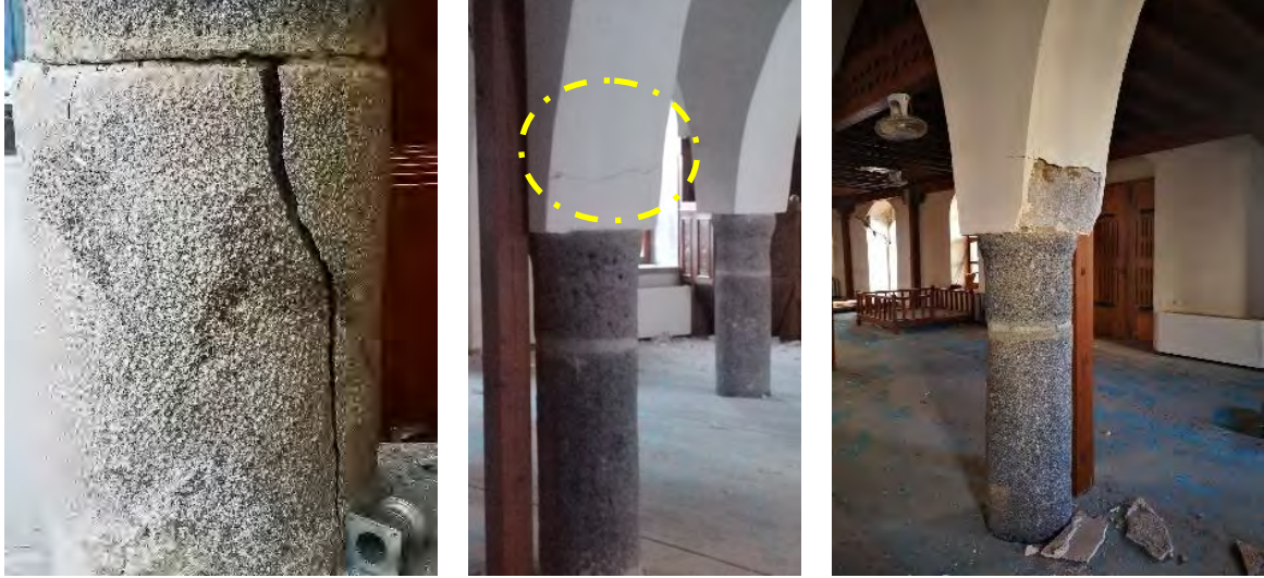
Şekil 150. Sütunlarda oluşan çatlak ve hasarlar
