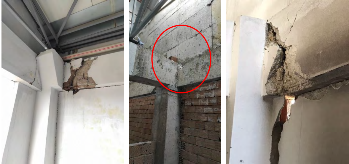
Şekil 106. Kolon-kiriş birleşim bölgesinde kiriş hasarları (Kahramanmaraş)
