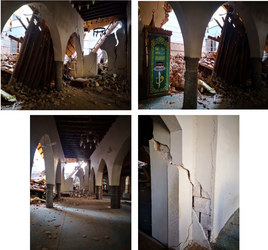
Şekil 151. Düzlem dışı etkilerden kaynaklı hasar ve göçmeler
