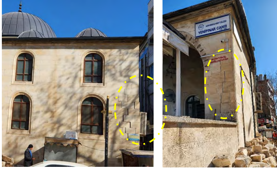
Şekil 142. Düzlem içi etkilerden kaynaklı diyagonal çekme çatlakları
