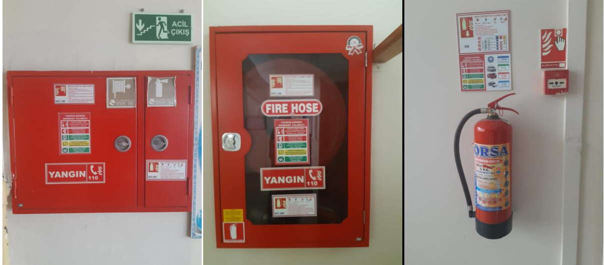
Şekil 7.7. Çeşitli yangın söndürme ekipmanları
